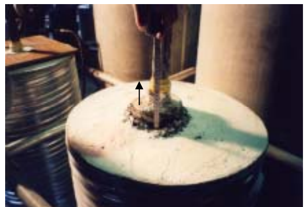
写真 - 7 クサビ型アンカー引抜け状況
