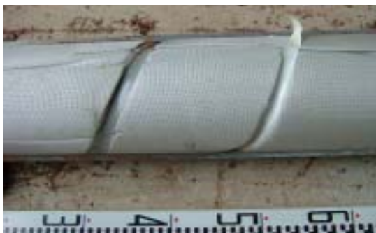
写真 2 グラウト漏出要因の例
