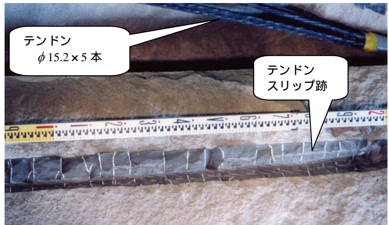
写真 4.2.1 摩擦（引張）型アンカー体クラック （荷重 1000kN，アンカー体長 1.5m，クラック間隔平均 6.5cm） （圧縮型でも同様にクラックが入ることが確認されている）
